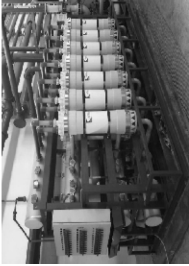
中电投鞍山电厂
